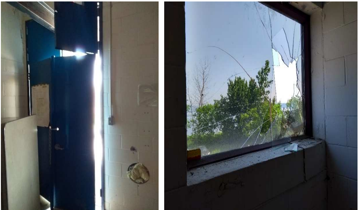
Photos 2 et 3 : Vandalisme sur les portes et fenêtres
