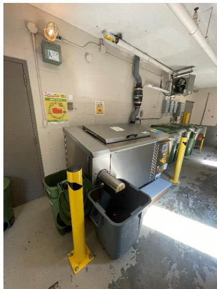
Figure 9 : Digesteur et bac de récupération du digestat
