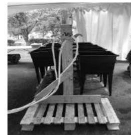
Tuyauterie de la station de lavage
