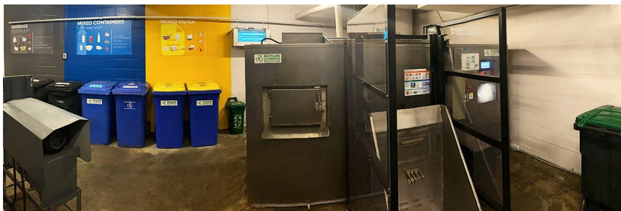
Figure 5-6 : Composteur Oklin dans un local à déchets
